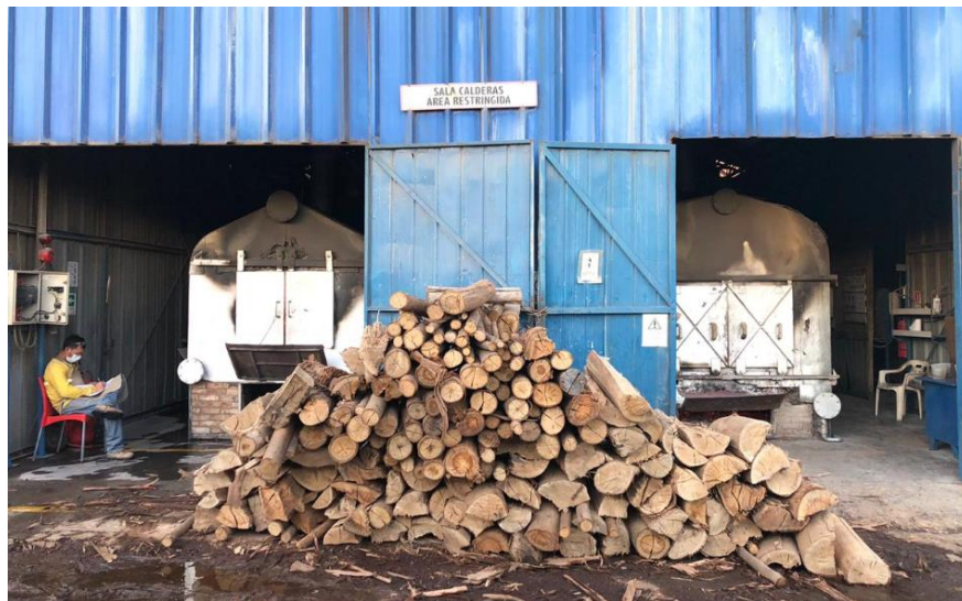
Figura 1: Calderas a Leña en Operación
